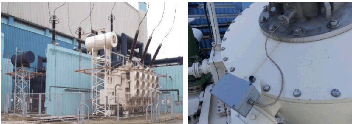
Slika 11: Glavni transformator GT1 (levo) in izvedba meritve napetosti skoznika faze C na glavnem transformatorju GT2 (desno)
